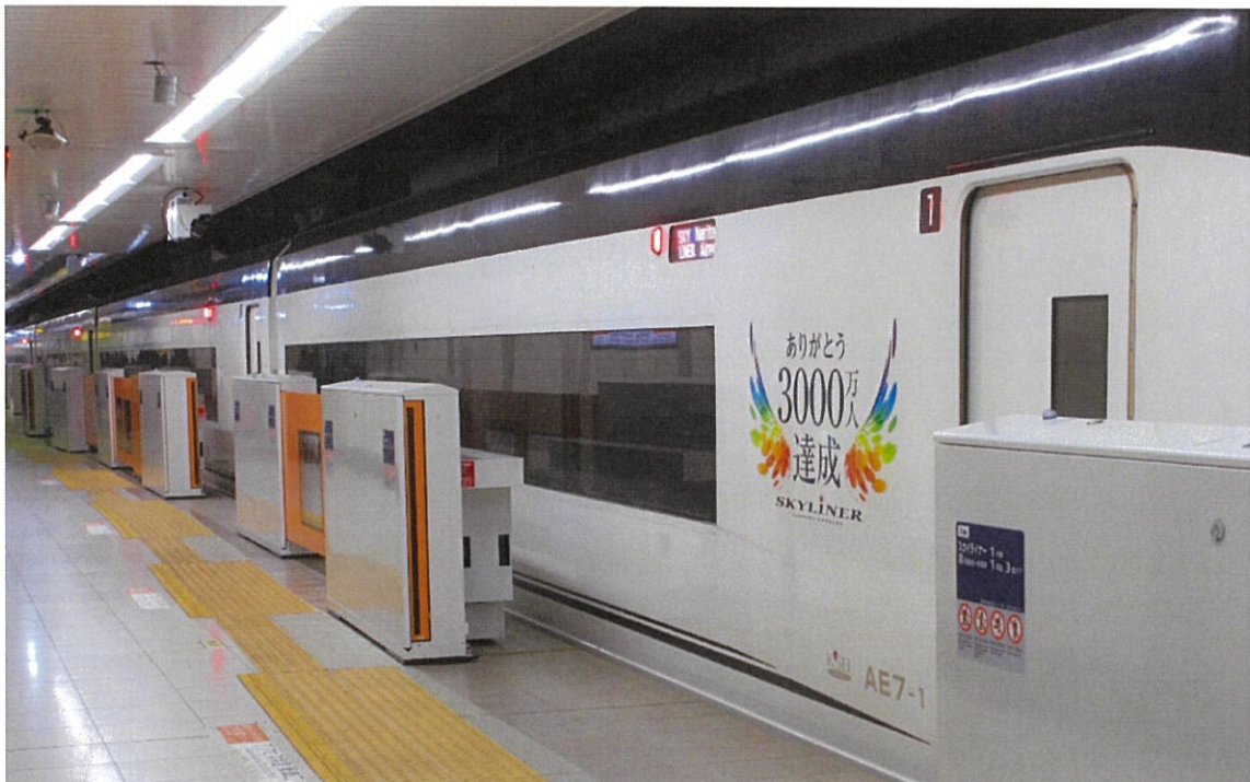
空港第2ビル駅ホームドア
