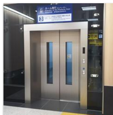
空港第2ビル駅 京成線24人乗りエレベーター
