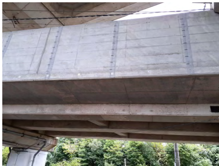
高架橋落下物対策 （落下対策ネット拡大写真）
